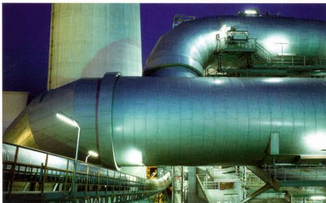
Licht- und Schattenspiele erzeugen oft eine faszinierende Stimmung. Das Foto zeigt Rauchgasrohre einer Rauchgasentschwefelungs-Anlage in einem Kraftwerk.
